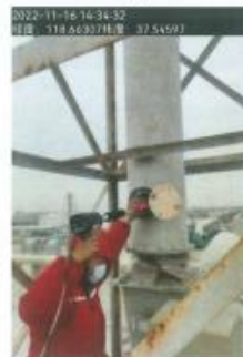
图 6 二车间排气筒 (DA009) 检测照片
