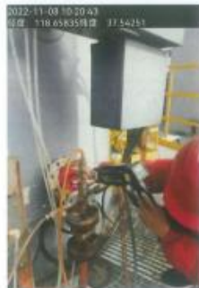
图 9 危废焚烧炉排气筒 (DA012) 检测照片
