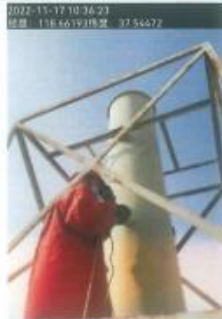
图 7 三车间 2 号排气筒 (DA010) 检测照片
