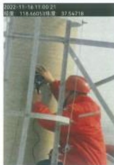
图 5 一车间-烯胺尾气吸附 (DA006) 检测照片
